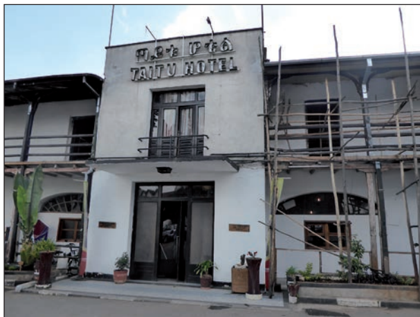
En del av Taytu hotell i Addis förstördes vid en brand förra vintern. Hotellet är i drift medan reparationer pågår.
