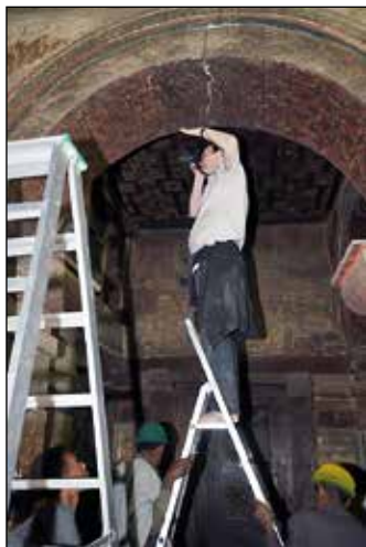
Skador i målningen dokumenteras.
